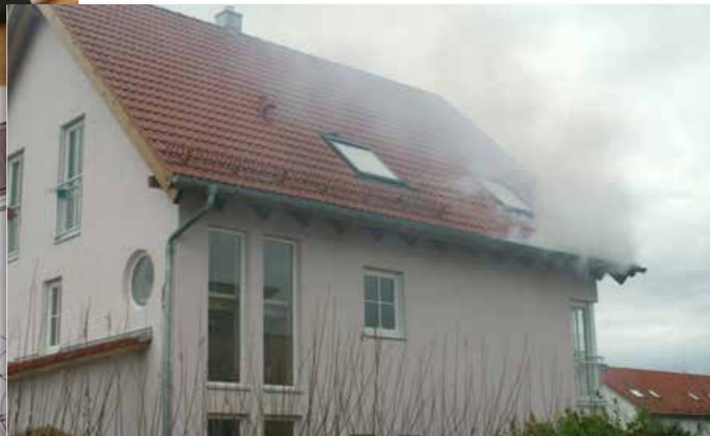
Slika: Pri testu zrakotesnosti megla uhaja iz notranjosti zaradi netesnege stika med steno in streho.
